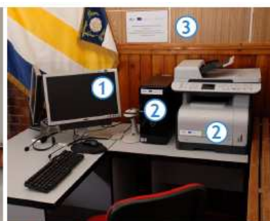
Celkový pohled na místní pracoviště CZECH POINT - musí být viditelné pokud možno všechny hardwarové komponenty pořízené za spoluúčasti IOP. Pokud máte např. tiskárnu umístěnou v jiné místnosti, je nutné pořídit samostatně i tento záběr. Fotografie by měla obsahovat samolepky č. 1, 2, a 3
